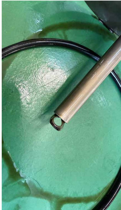
Unbekanntes Objekt schaut aus dem Ansaugrohr des Öltanks heraus
